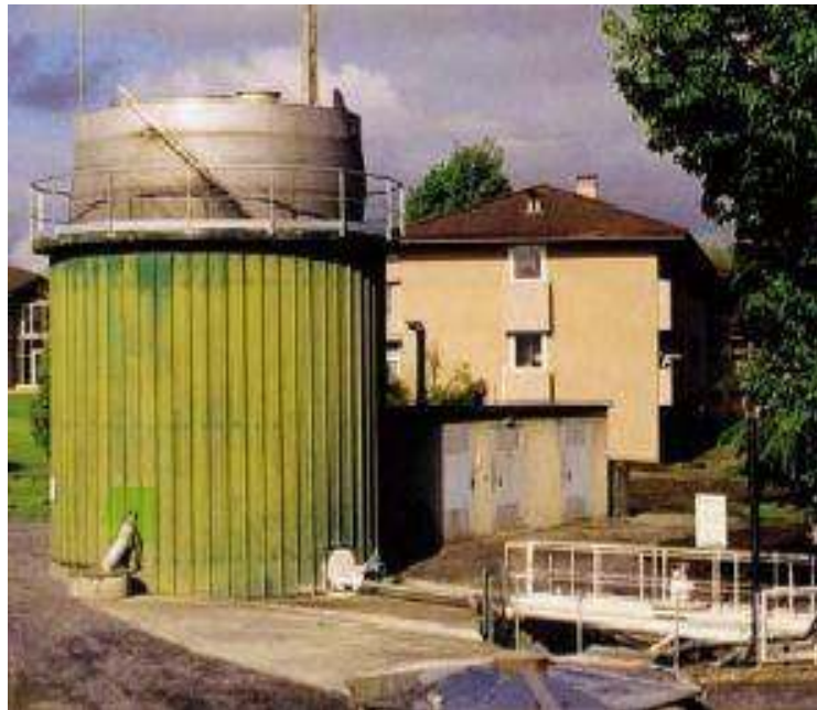
Photo 1 : réacteur infiniment mélangé –digesteur gazomètre, 15m 3 /jour d'effluent – 5000m 3 /an de lisiers de porcs - AGPM, Montardon (F-65)
