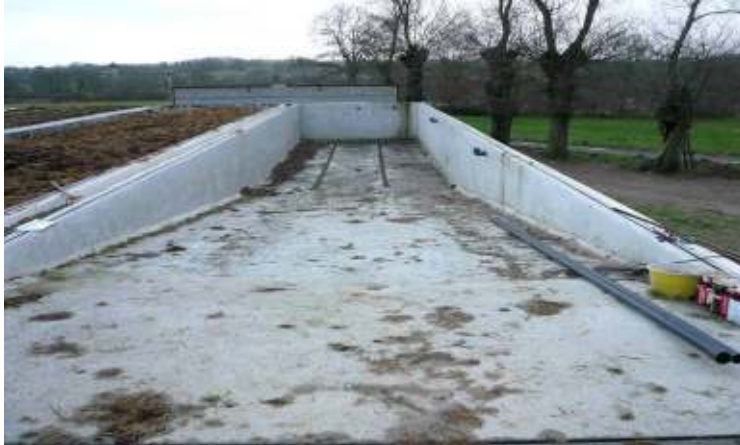
Photo 5: réacteur discontinu - intérieur d'une fosse/digesteur pour fumiers bovins – Installation de D.Brosset (F-85)
