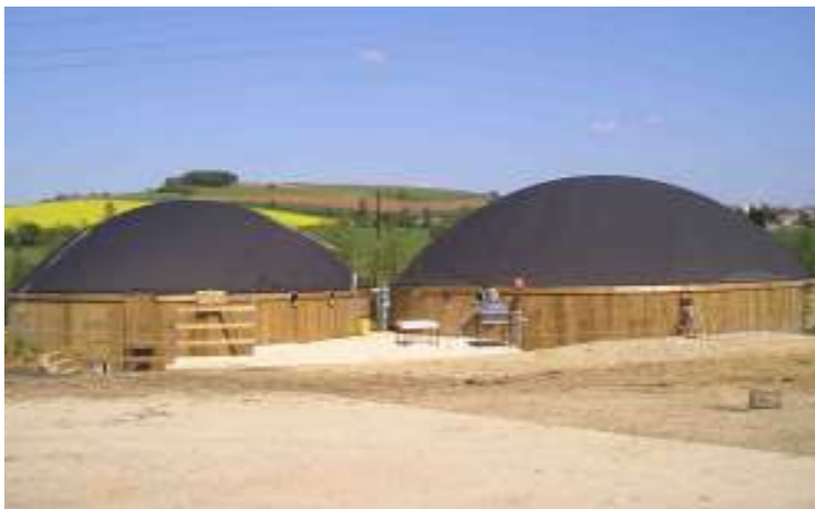
Photo 3: réacteur continu infiniment mélangé - fosses digesteur/gazomètre - installation du GAEC Oudet (F)
