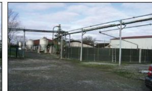
Pipeline (photo : P. Bioulac)
